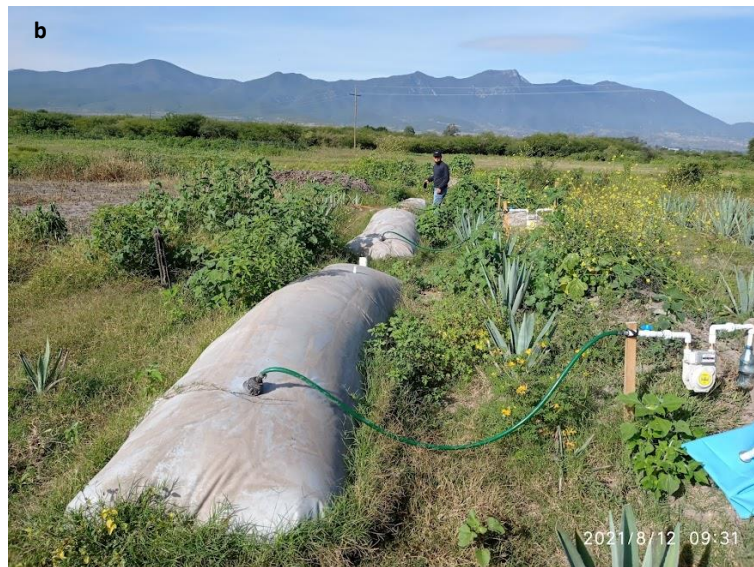
Figura 3. a) Biodigestor tubular con base en las dimensiones utilizadas por Chará y Pedraza (2009), b) biodigestores tubulares instalados para la producción de biogás y biofertilizante a partir de vinazas de mezcal en Tlacolula de Matamoros, Oaxaca.
