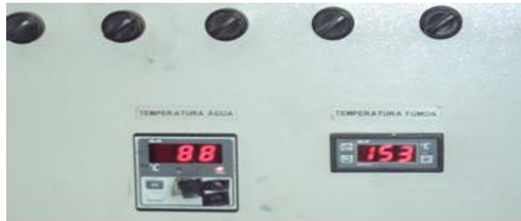
Figura 3-8. Indicador de temperatura de gases de la caldera de un secador de madera
