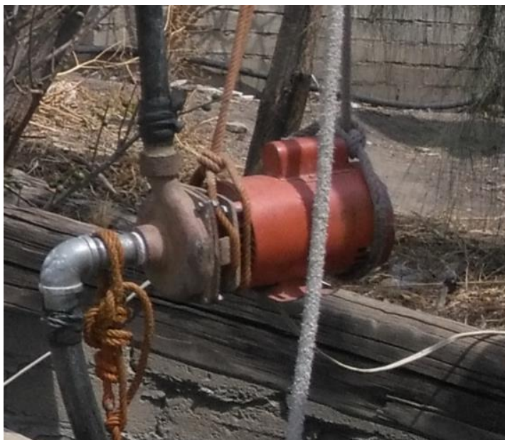
Figura 32. Bomba superficial de agua, utilizada para riego agrícola en la zona de estudio, (2017).
