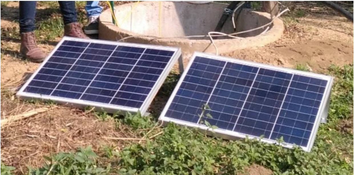
Figura 13. Conexión de paneles fotovoltaicos para la generación de energía eléctrica (2017).
