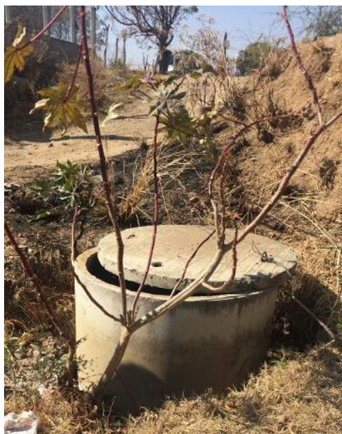
Figura 27. Pozo de absorción 6
