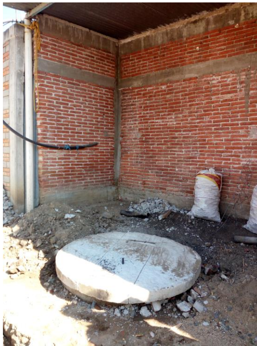
Figura 26. Pozo de absorción 5.
