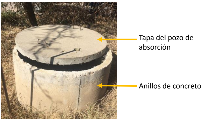
Figura 18. Pozo de absorción
