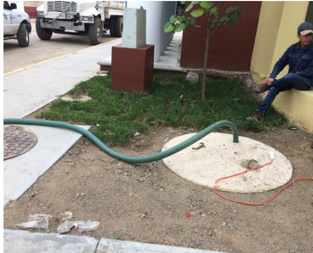
Figura 30. Pozo de absorción 8.
