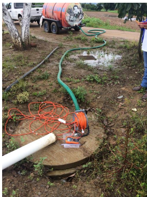
Figura 28. Pozo de absorción 7.
