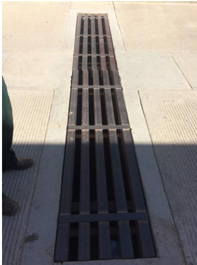
Figura 35. Canal arenero con rejillas
