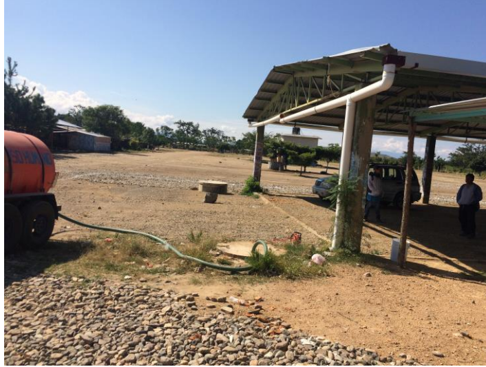
Figura 33. Pozo de absorción 10
