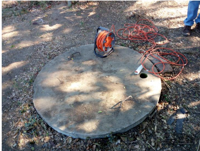
Figura 36. Pozo de absorción 12
