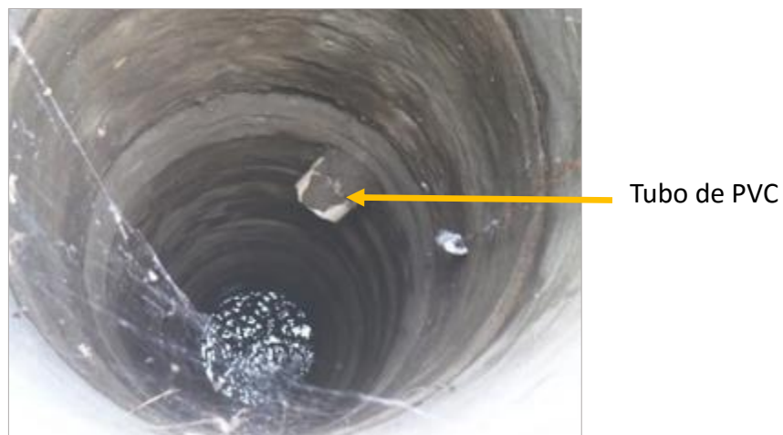
Figura 19. Pozo de absorción
