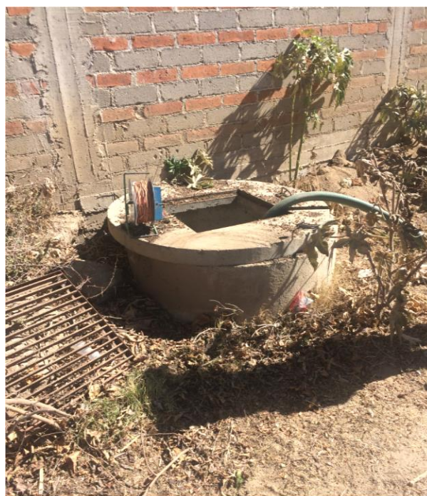
Figura 21. Pozo de absorción 1
