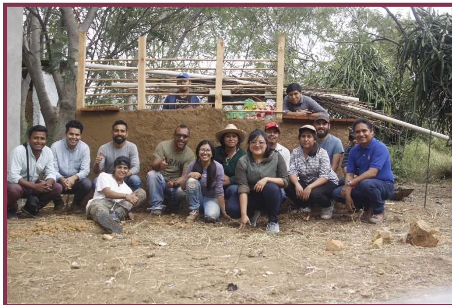
figura: 102 Celebrando el aprendizaje en la construcción de un muro de Bajareque.
