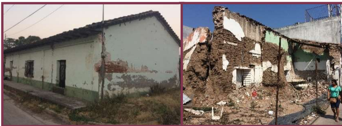
figura: 7 Problemáticas identificadas en las viviendas en el Istmo de Tehuantepec después de los sismos del 2017.
