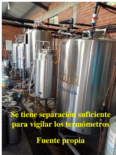
Imagen 1.- Maceradores con controles de temperatura (Cervecería Doble filo)
