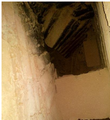
Figura 40. Defecto en la construcción del túnel de interconexión, se observa la formación de una pequeña bóveda.
